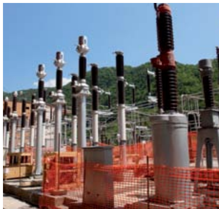
· V okviru prenove zunanjega stikališča so bili zamenjani ločilnik, merilni transformator in podporni ter skoznji izolatorji
