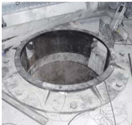
· Temelj starega ohišja vmesnega ležaja
