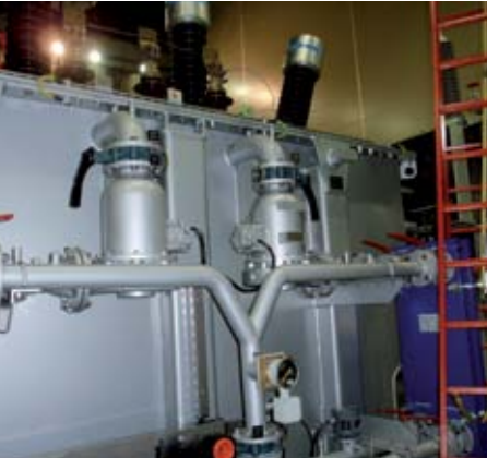
· Hladilni sistem transformatorja
