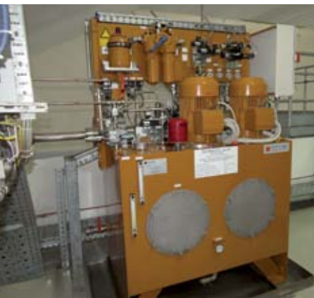
· Hidravlična naprava turbinskega regulatorja
